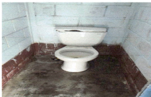
Foto 3: ACCESORIOS DE BAÑOS
